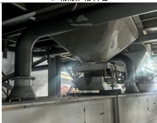
5#转运废气管道
