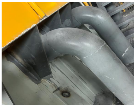
5#精炼炉落料仓集气管道
